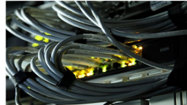
Cable de Fibra Óptica
