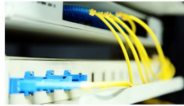
Cables de fibra óptica
