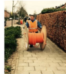
Cable de Fibra Óptica
