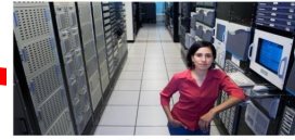
Data Center de ETB
